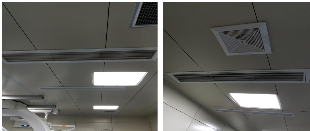
图 4-8 机房内通排风装置
